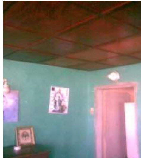
Figure 31 : Habitat avec un plafond sans trou, le mur lisse sans fente et sans espace (Dangbo)
